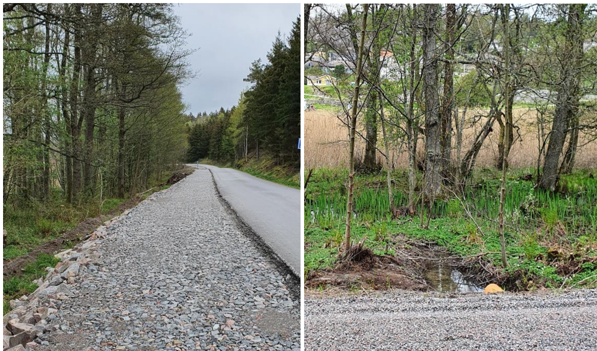
Figur 12 Bräckevägen (t.v.) och en av trummorna som leder dagvattnet från diket på Bräckevägens östra sida till Anråsälven (t.h.)
