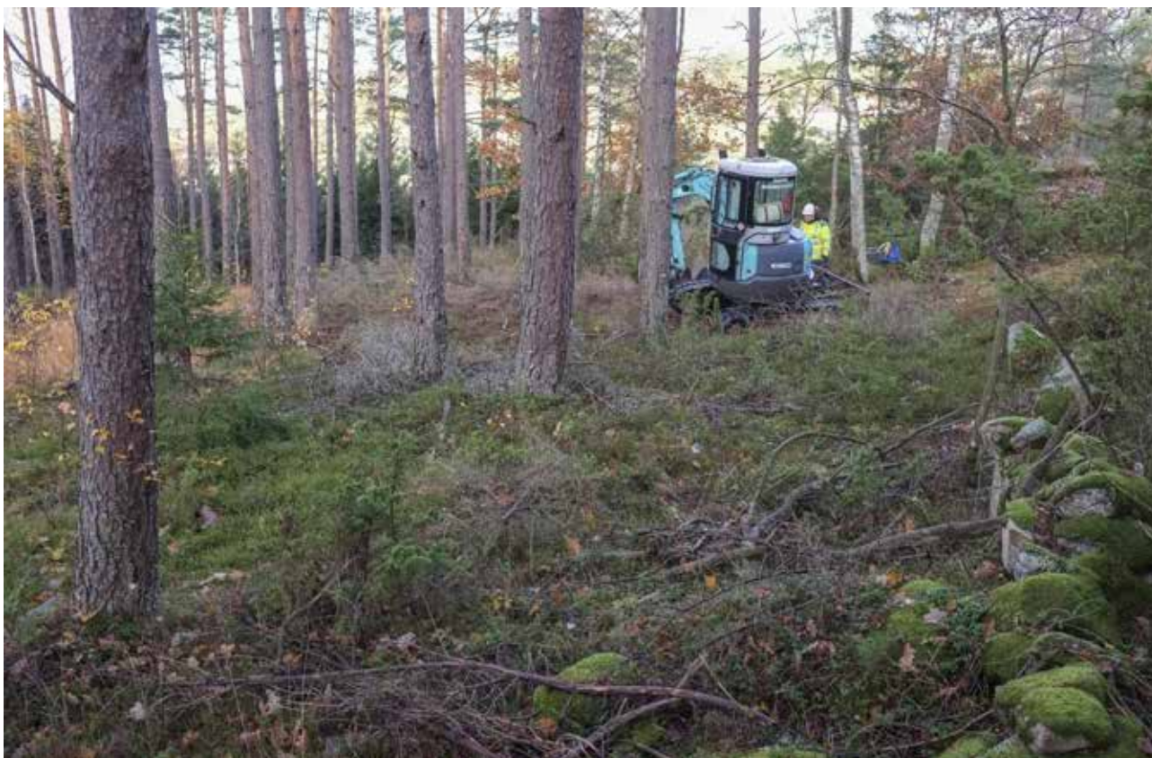
Illustration 6. I områdets nordöstra del fanns en mindre plåtå med gles tallskog där schaktningen utfördes. Till höger i bild den stengärdesgård som löper i fastighetsgränsen mot nordost. Valdemar diskuterar med grävmaskinisten. Bilden är tagen i närheten av schakt 1 och 3. Foto mot nordväst.
