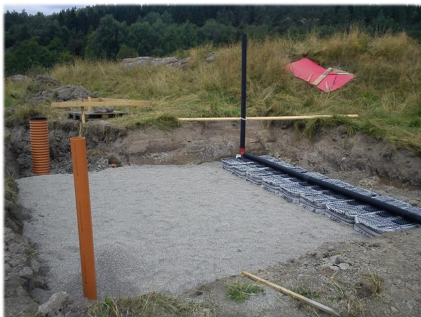
Anläggning med filtermoduler
